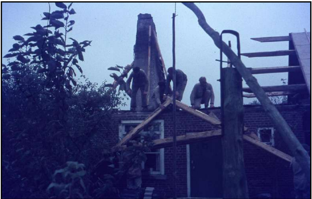
In 1969 wordt het oude dak vervangen en ongeveer een meter verlaagd. Goed te zien op bovenste foto, waarbij links het oude dak en rechts het nieuwe deel.
